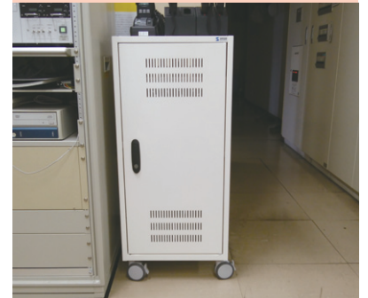
西横浜駅 の保管庫 設置例
