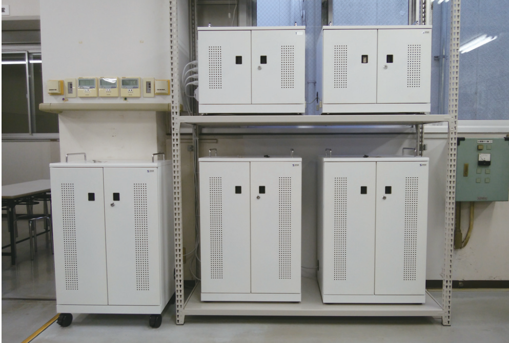
かしわ台 電車区 の保管庫 設置例
